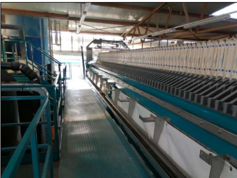
Impianto filtropressa per disidratazione fanghi
