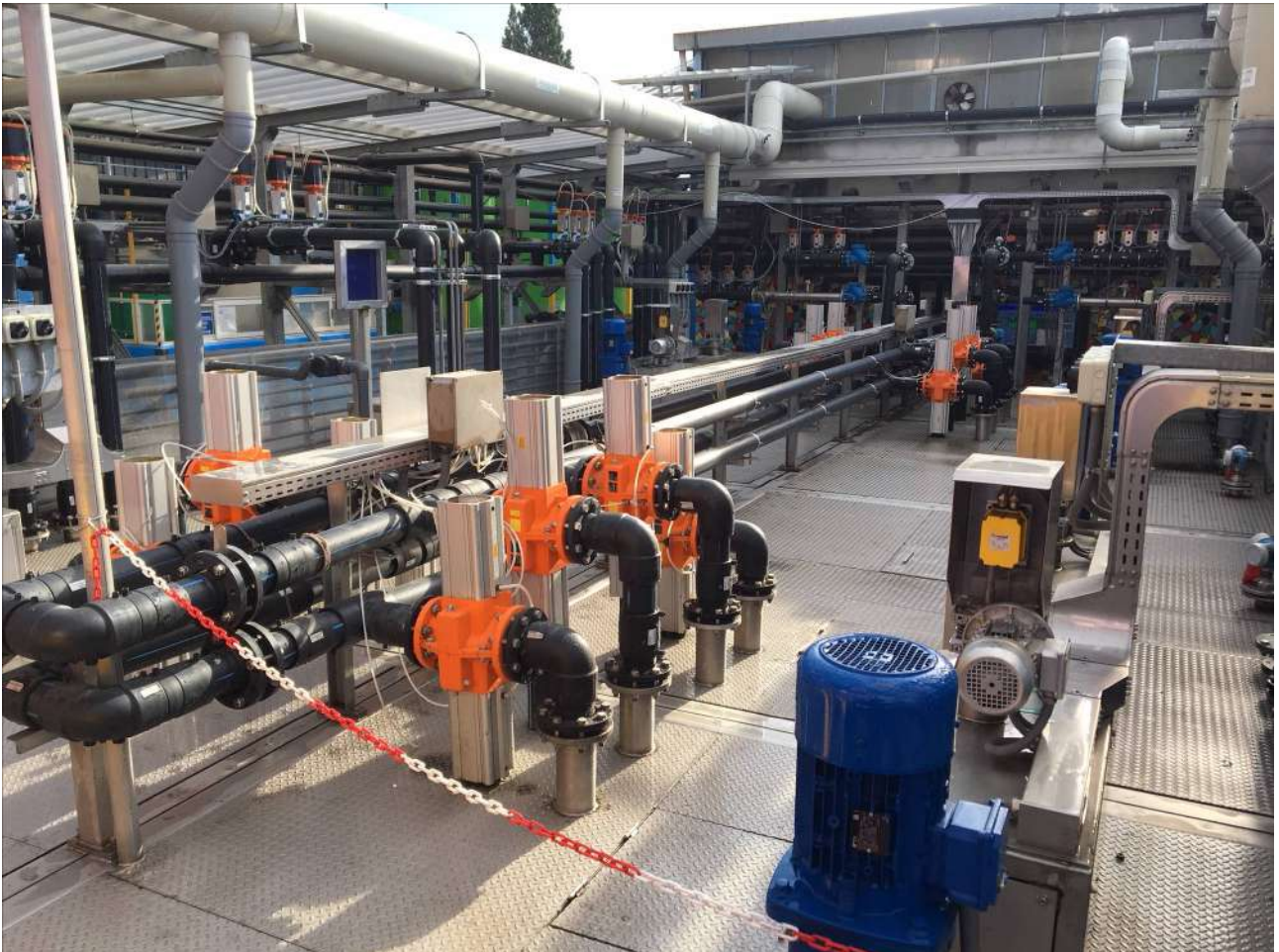
Reattori di trattamento chimico-fisico (sez.400)
