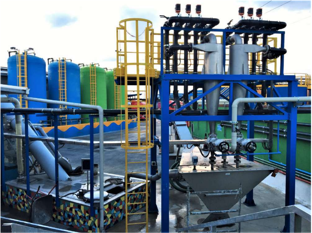
Vasche di scarico – Impianti di eliminazione solidi grossolani (sez.400)
