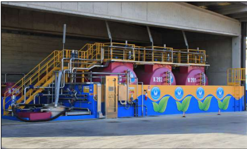
Impianto di scarico e stoccaggio reflui oleosi (sez.200)
