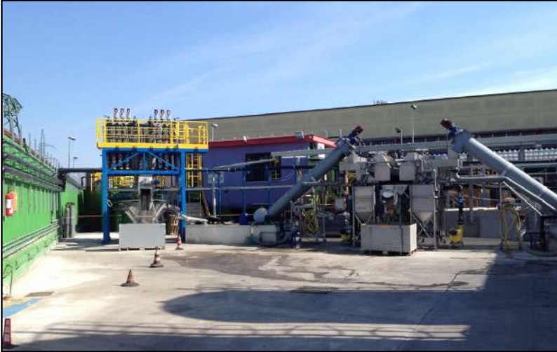
Area di scarico e impianti di eliminazione solidi grossolani
